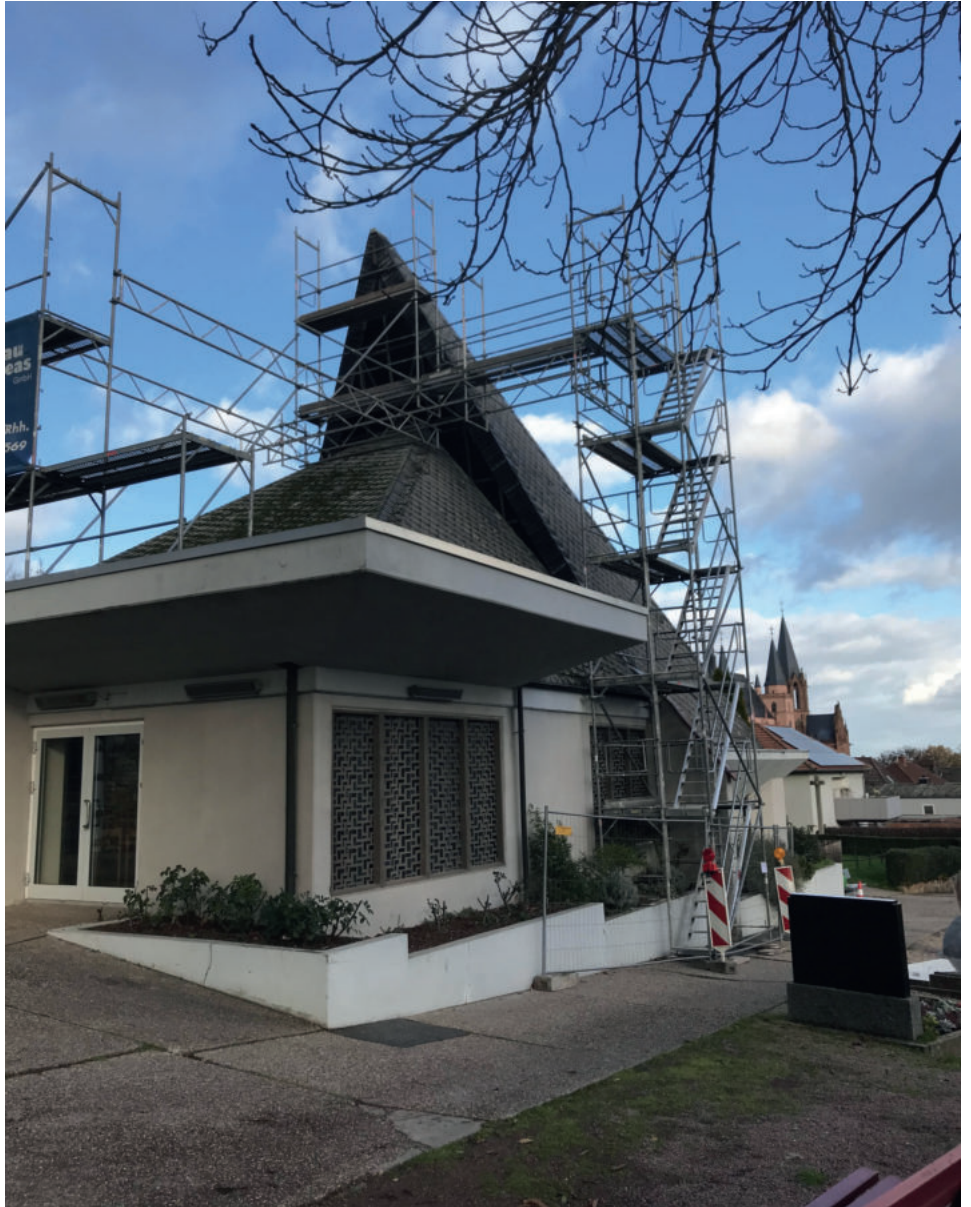
Die aktuellen Arbeiten sind nur das Nötigste. Eine umfassende Sanierung ist unausweichlich.
